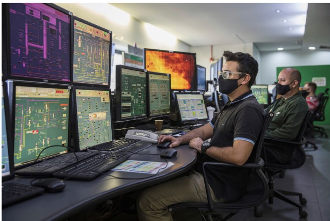
Sala de Controle da Unidade Monte Alegre em Telêmaco Borba (PR). Foto: Eduardo Knapp.
