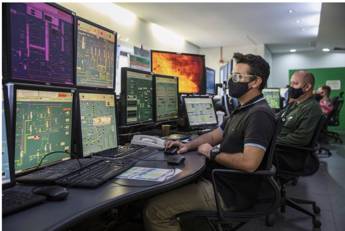
Telemaco Borba, , BRASIL, 09-02-2021: KLABIN Fabrica Monte Alegre. Operadores na Sala de Controle (Foto: Eduardo Knapp/Eduardo Knapp, ).
